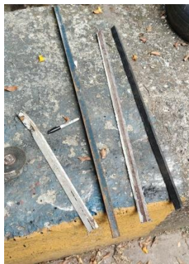
Ilustración 5 Perfiles de soporte para instalación de Aires acondicionados, (fuente propia, 2021)
