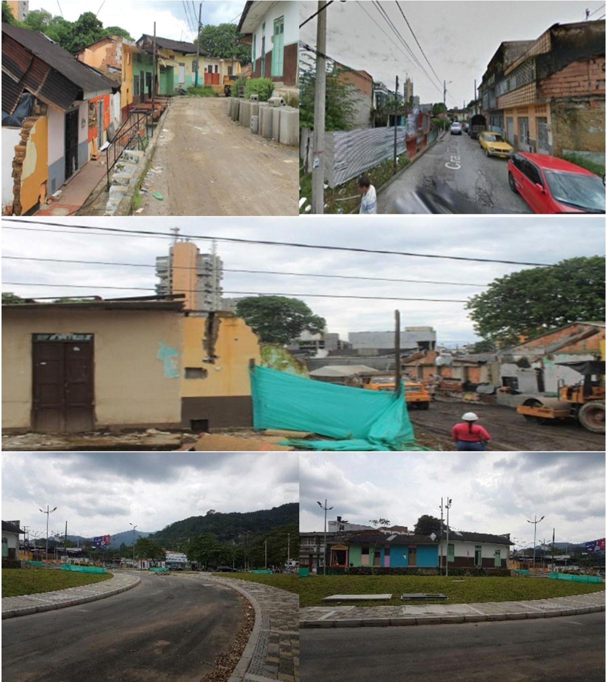
Figura 3. Sector El Pedregal durante la demolición e intervención con las casas ya demolidas. Fuente: Desarrollado por la autora
