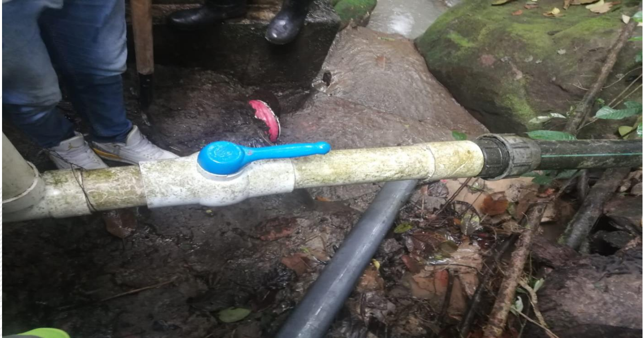
Figura 19. Tubería de red de 4 pulgadas con acceso.
