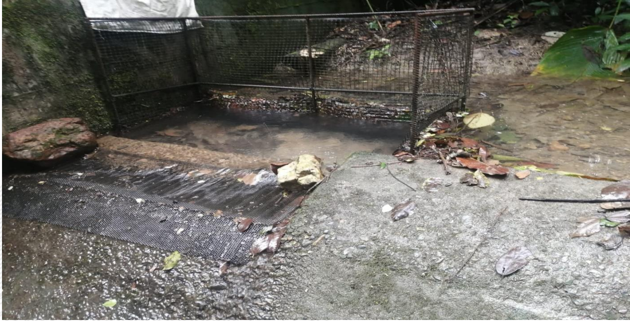
Figura 21. Cámara de excesos
