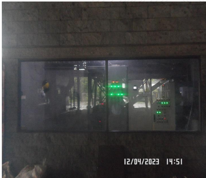
Cuarto de control de calderas
