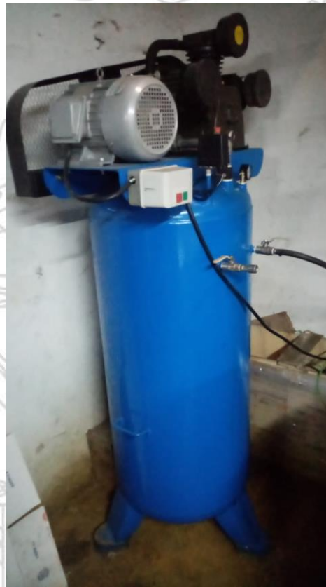
Imagen 12. compresor, fuente: autor de este trabajo
