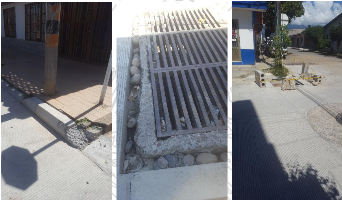
Figura 20. Faltantes de contrato. Fuente: Propia
