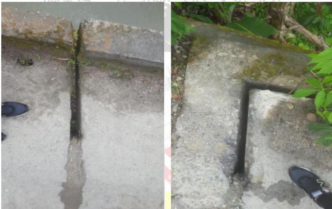
Figura 11. Separaciones de las juntas en el tablero y estribos del puente.
