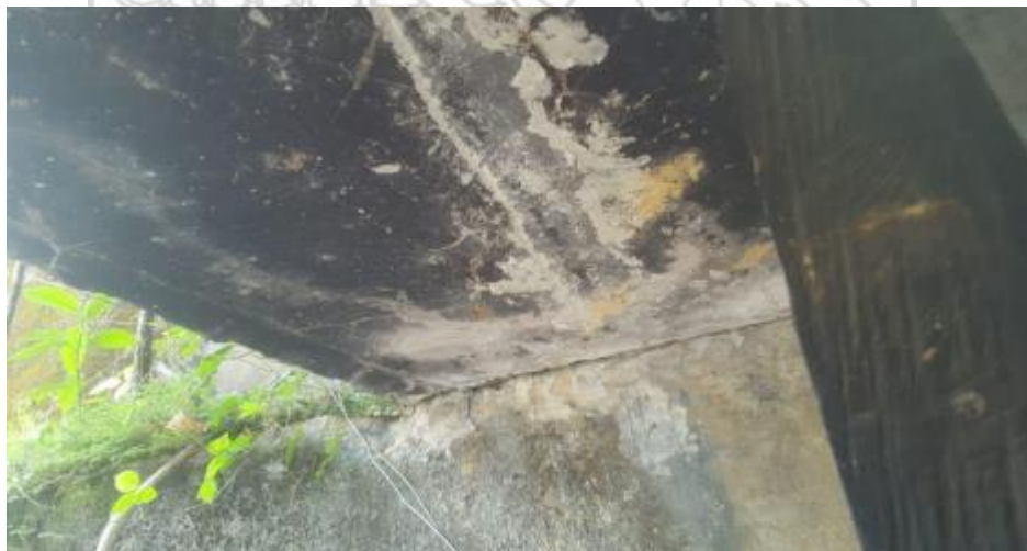
Figura 13. Oxidación en la estructura. Fuente: Propia.
