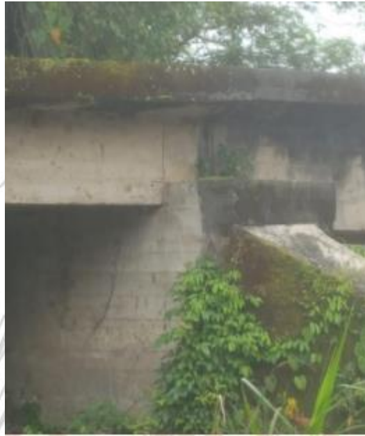
Figura 14. Dilataciones en la viga del puente. Fuente: Propia.
