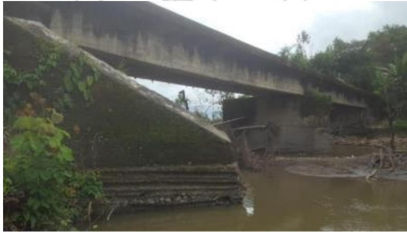
Figura 10. Estribo con un grado de inclinación por socavación.
