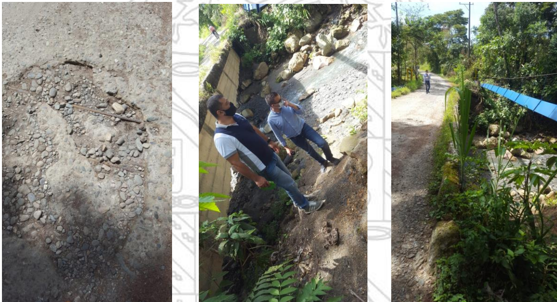
Figura 30. Estado actual del puente de la Vereda Cobalto.
