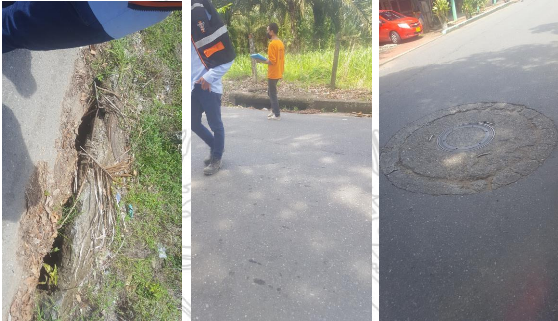
Figura 22. Estado actual de la vía. Fuente: Propia
