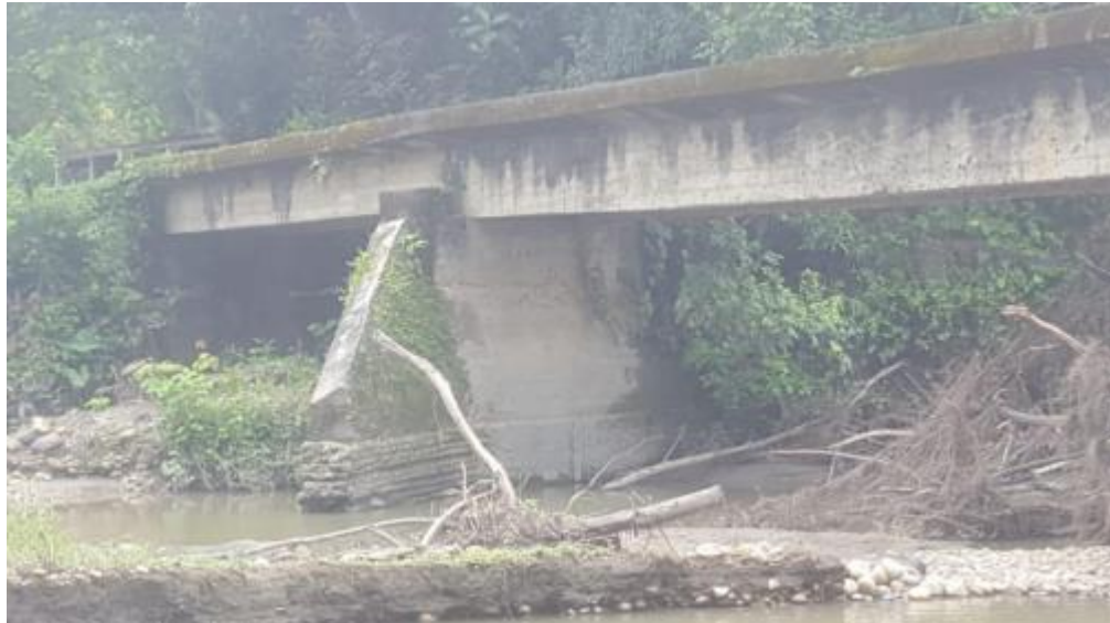
Figura 12. Estado del puente y sus afectaciones. Fuente: Propia.
