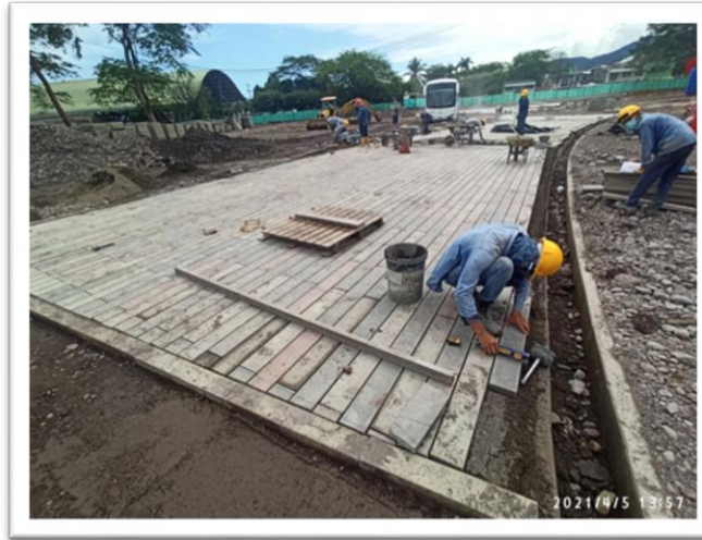
Verificación de niveles para la instalación de loseta deck en espacio público.
