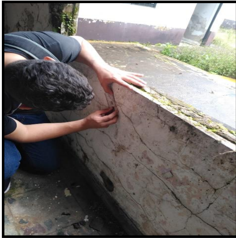
Ilustración 7: Levantamiento de grietas fondo rotatorio
