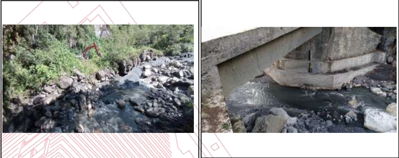
Ilustración 38. Riesgo de socavación.
