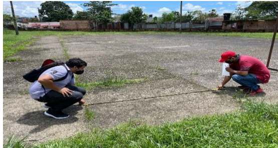
ilustración 12. Medida de daños
