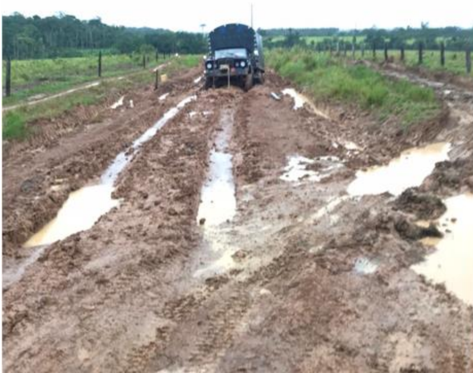
Ilustración 13. ESTADO DE LA VIA QUE CONDUCE A LA VEREDA LA PAZ MUNICIPIO DEL RETORNO GUAVIARE
