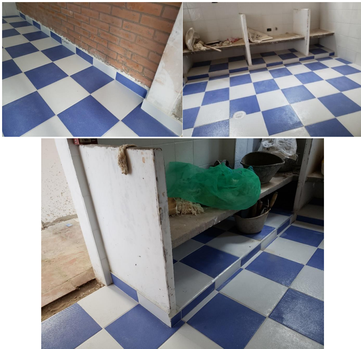
Ilustración 41. Guarda escoba baldosa línea matiz
