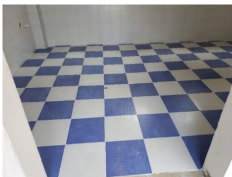
Ilustración 36. Piso en cerámica 45 x 45 tráfico comercial alto
