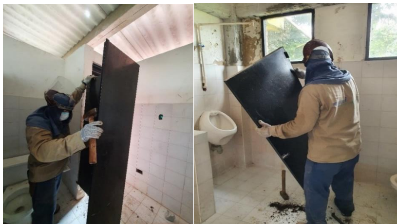
Ilustración 6. Desmante de divisiones modulares metálicas, incluye traslado hasta sitio de cargue o almacenamiento
