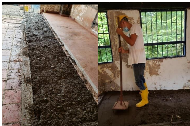
Ilustración 19. Relleno con material mixto de río sin procesar tamaño Max 2" suministro, extendido, nivelación, humedecimiento y compactación manual con equipo liviano.
