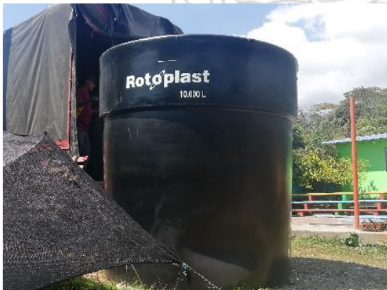
Figura 23. Tanque de almacenamiento
