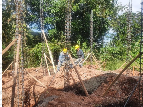
Figura 10. Condición de pedestales
