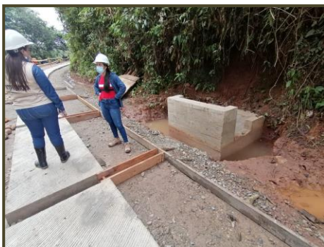
Ilustración 44. Captación de Box Culvert
