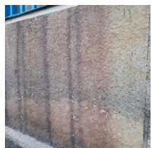
Humedad y suciedad.
