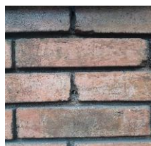
Desprendimiento de ladrillo.
