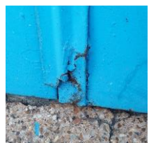
Óxido y agrietamiento en puerta metálica.
