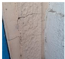
Fisuras y grietas en columnas.
