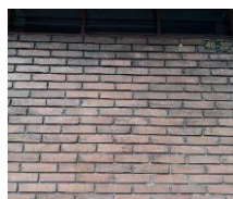
Humedad en ladrillo a la vista.
