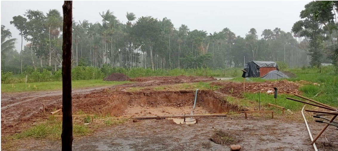
Figura 50 Afectaciones de tiempo: lluvias.
