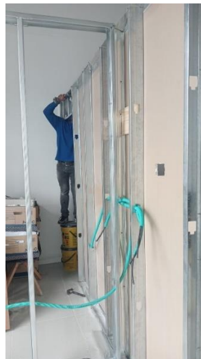
Figura 38 Instalacion eléctrica y divisiones internas.
