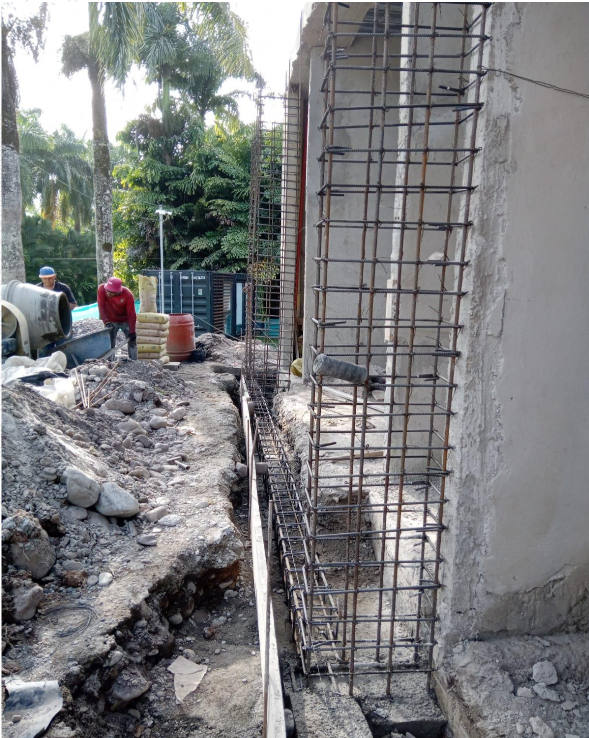
Figura 23 : Obra casa campestre condominio la primavera- Viga y columnas parte frontal de la propiedad
